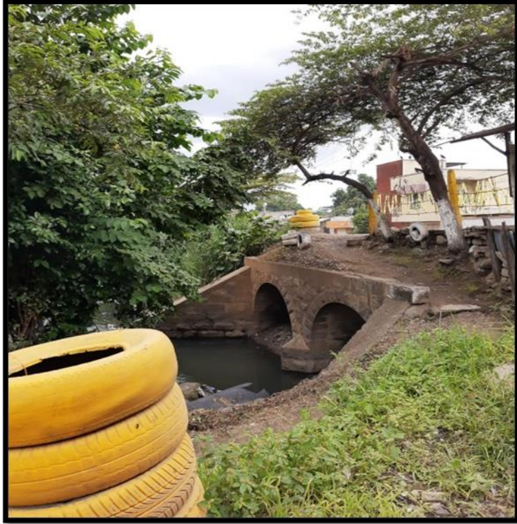
Figura 31. Desagüe 1. Fuente: elaboración propia
