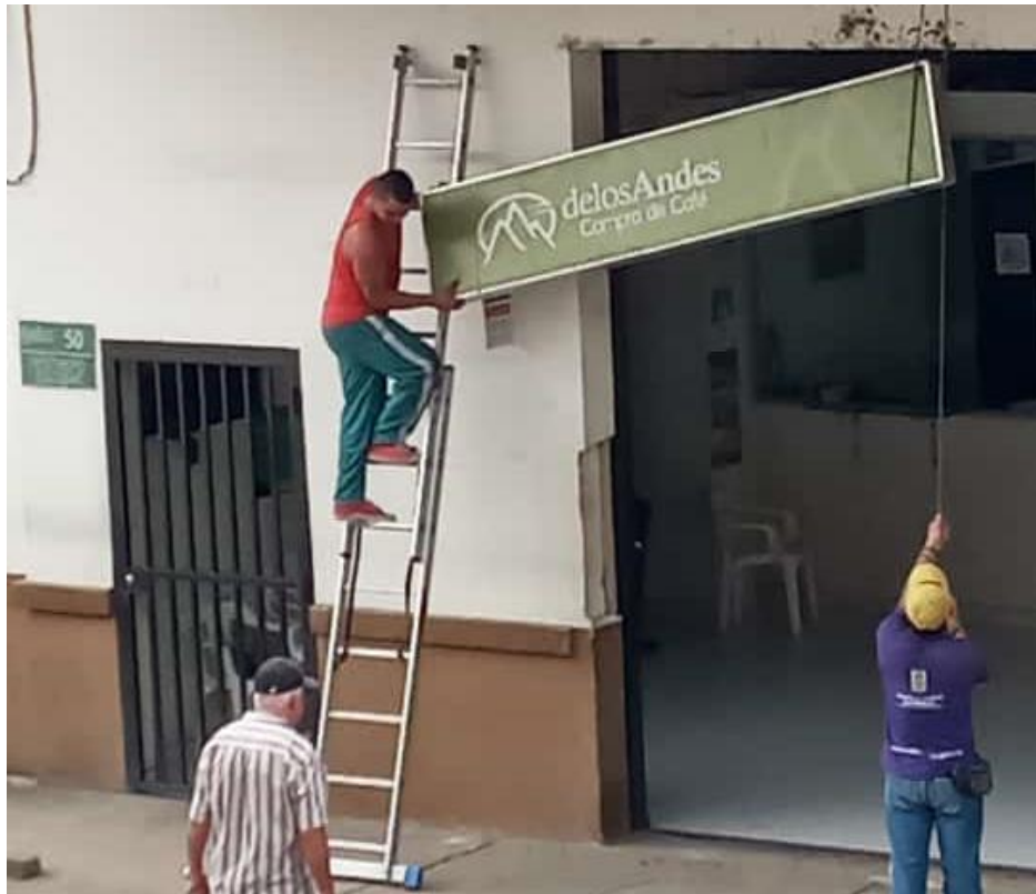
Ilustración 72 Desmonte de fachada de bodega de Cooperativa de los Andes, foto propia
