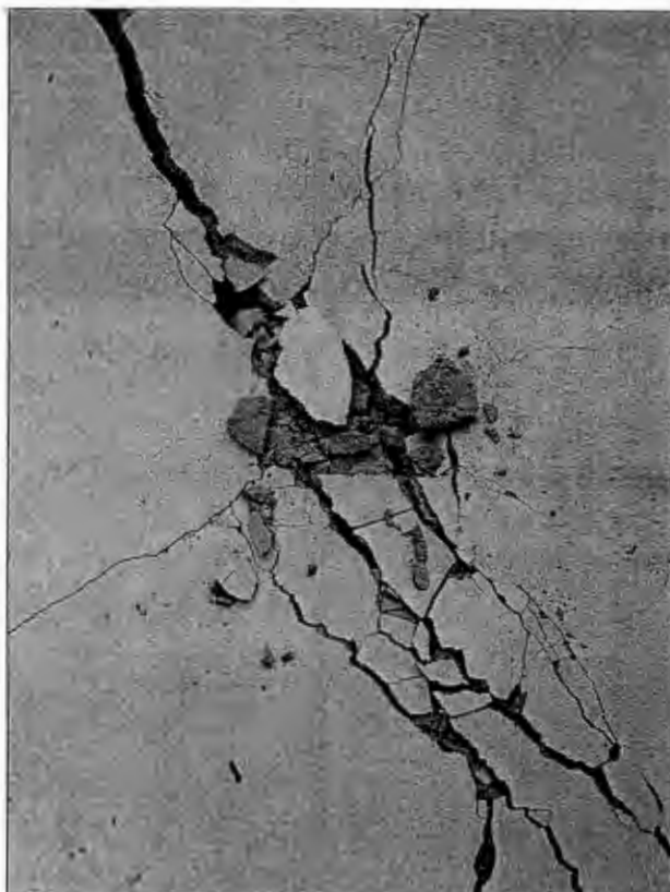
Grieta. Demolición de la casa de Checa #18, Chimalistac, DF. Antonio Zirión. 27 de enero de 2006.
